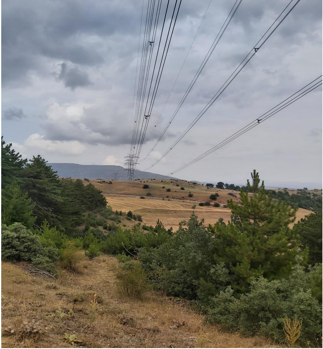
Şekil 2.2 380 kV enerji iletim hattı (Fotoğraf: Mehmet KORKMAZ)
