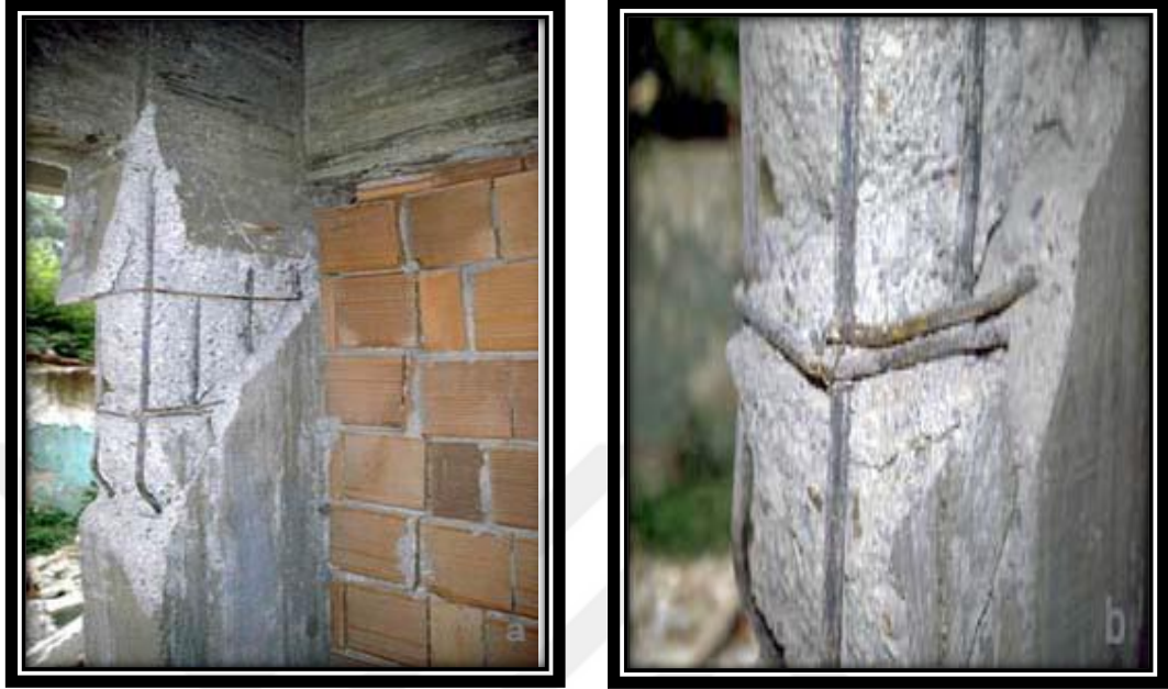
Şekil 1.2. 1999 Marmara depreminde hasarlı kolon [1]
