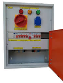
Şekil 2.30. Asansör elektrik panosu
