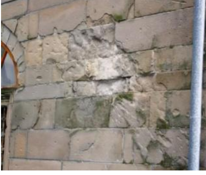
Resim 3.21. Savaş zamanında hasar gören duvar (Nihada Pustahija)
