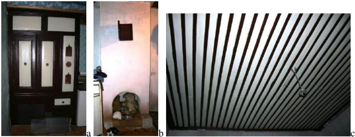
Resim 3.64. (a) Dolap, (b) ocak ve (c) süslemesiz basit bir tavan (Nihada Pustahija)
