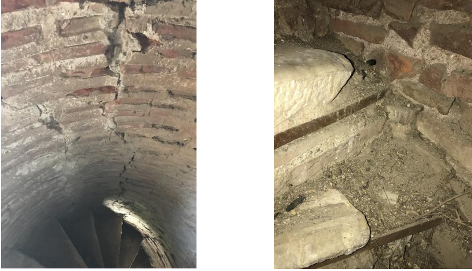
Şekil 5.9 Batı cephesi minaresinde gövde ve basamaklardaki hasarlar.
