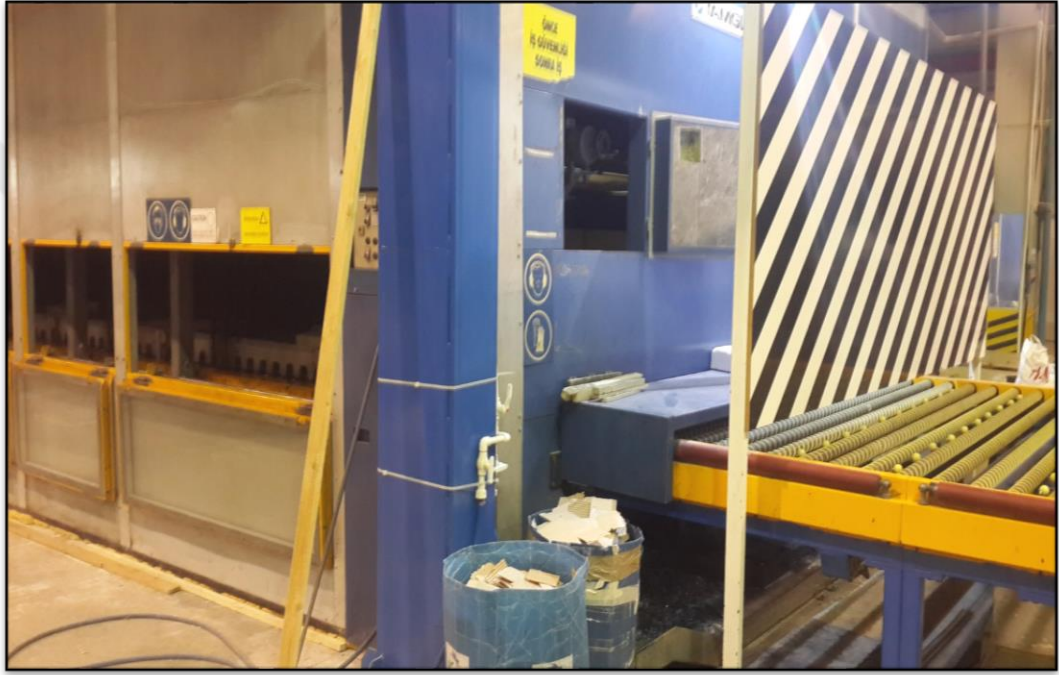
Şekil 4.2. Elektrikli cam temperleme fırınının cam soğutma bölümü görünümü
