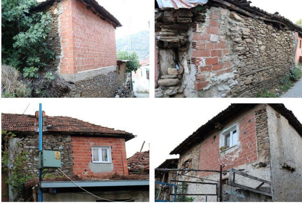
Şekil 5.61 Eğridere köyünde aslına uygun olmayan malzeme ile onarılan duvar örnekleri (Kişisel arşiv, 2018)
