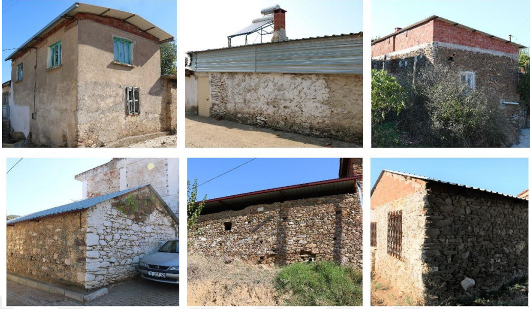
Şekil 4.79 Peşrefli köyünde aslına uygun olmayan malzeme ile tamamlanan çatı örnekleri (Kişisel arşiv, 2018)
