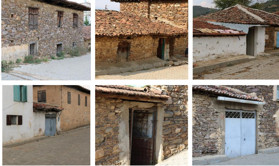
Şekil 4.73 Peşrefli köyünde yeni kaplamalar ile yol kotunun yükselmesi ve toprak altında kalan giriş örnekleri (Kişisel arşiv, 2018)
