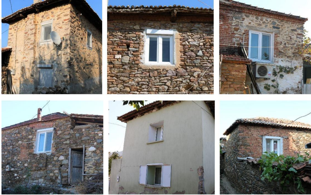
Şekil 4.81 Peşrefli köyünde pencere doğramalarının aslına uygun olmayan malzeme ile değiştirilmesi (Kişisel arşiv, 2018)
