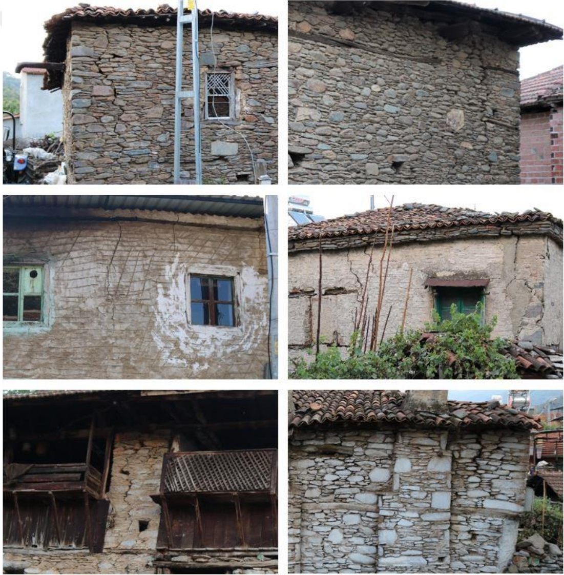
Şekil 5.63 Eğridere köyü geleneksel konutlarında görülen strüktürel çatlak örnekleri (Kişisel arşiv, 2018)
