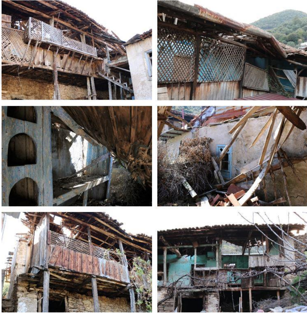
Şekil 5.64 Eğridere köyünde çatısı yıkılan konut örnekleri (Kişisel arşiv, 2019)
