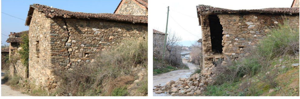
Şekil 4.83 Peşrefli köyü 196 ada 11A parselde bulunan konutun köşesindeki strüktürel çatlaktan yıkılması (Kişisel arşiv, 2018)
