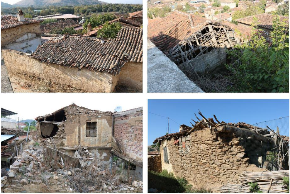
Şekil 4.84 Peşrefli köyünde çatısı yıkılan konut örnekleri (Kişisel arşiv, 2018)
