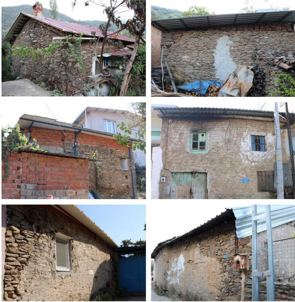
Şekil 5.60 Egridere köyünde aslına uygun olmayan malzeme ile onarılan çatı örnekleri (Kişisel arşiv, 2018)
