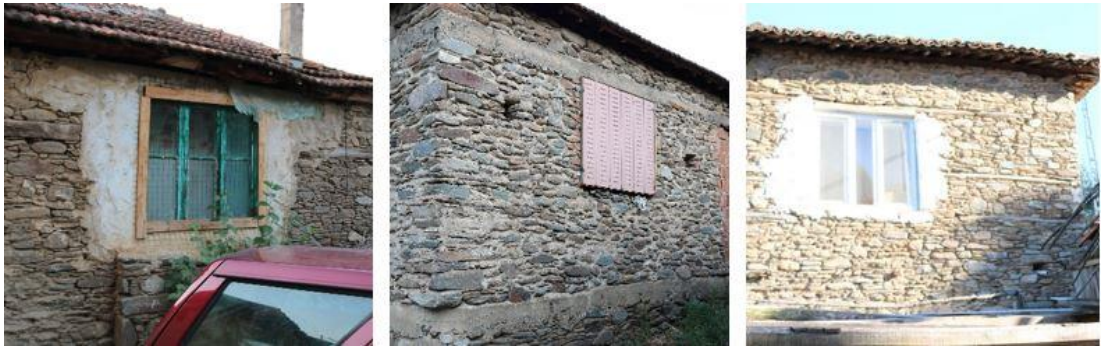
Şekil 5.59 Eğridere köyünde açıklık oranları değiştirilen yapı örnekleri (Kişisel arşiv, 2018)
