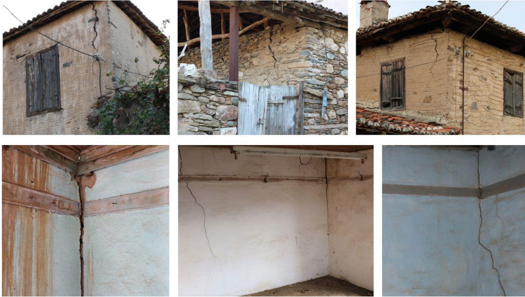
Şekil 4.82 Peşrefli köyü geleneksel konutlarında görülen strüktürel çatlak örnekleri (Kişisel arşiv, 2018)
