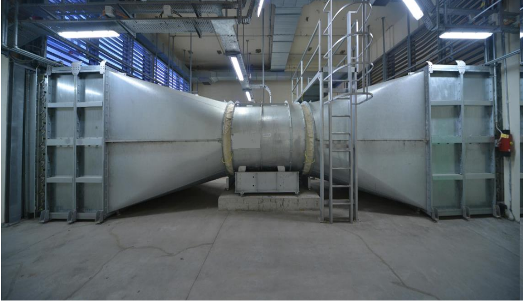
Şekil 2.3 Tünel havalandırma fanı (TVF)
