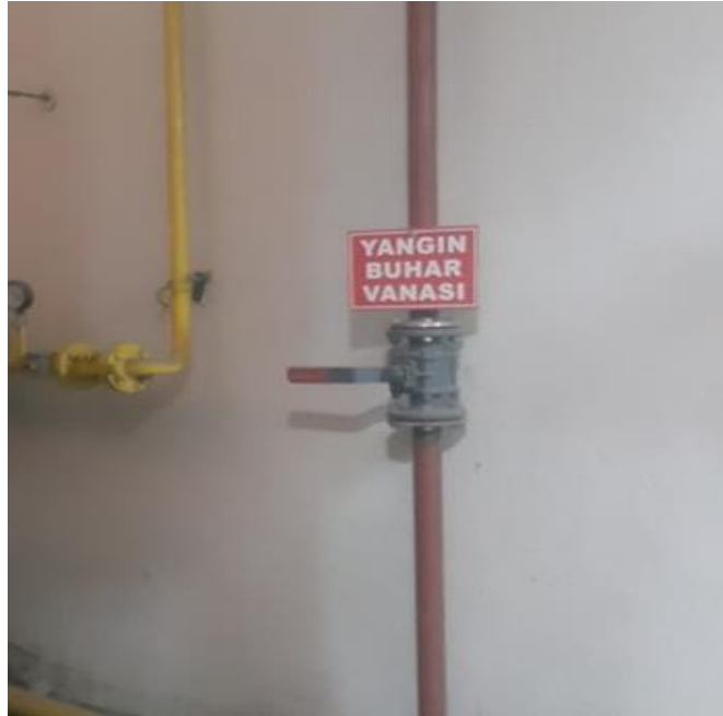
Şekil 4.18. Yangın buhar vanası.
