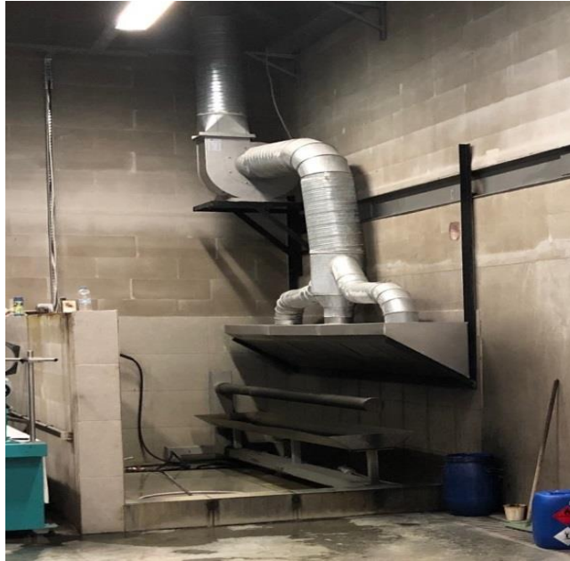
Şekil 4.16. Havalandırma sistemi olan şablon yıkama bölümü
