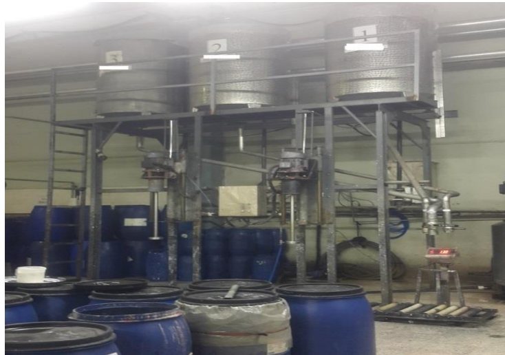
Şekil 4.7. Baskı boya mutfağı.
