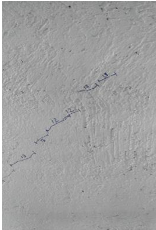
Şekil 3.29. On ikinci ve on üçüncü döngüde oluşan diagonal çatlaklar
