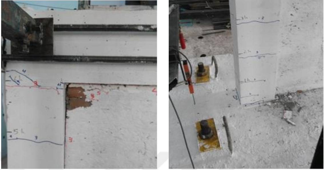
Şekil 3.28. Yedinci döngü sonu görülen çatlaklar
