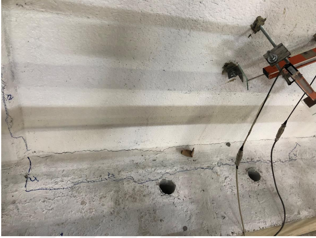
Şekil 3.38. Temel bindirmelerinde meydana gelen ayrılma.
