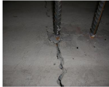
Şekil 5.7. Betonun yarılması (Gürbüz 2007)
