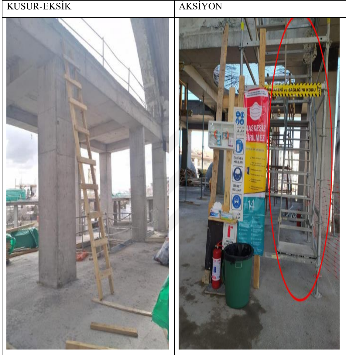
Şekil 4.21: Yanlış malzemeyle oluşturulan merdivenlerdeki kusur ve aksiyon
