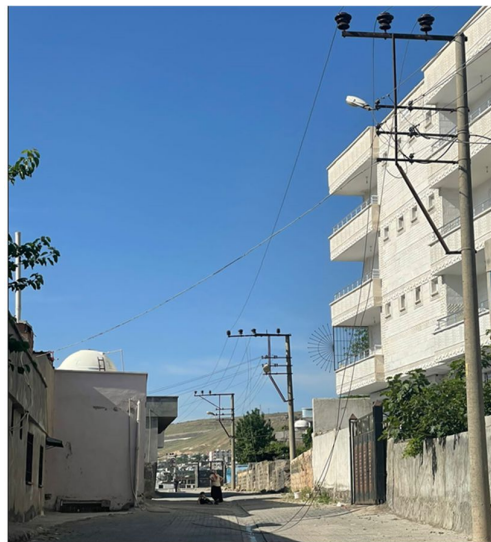
Şekil 3.5. OG iletken kopuğu
