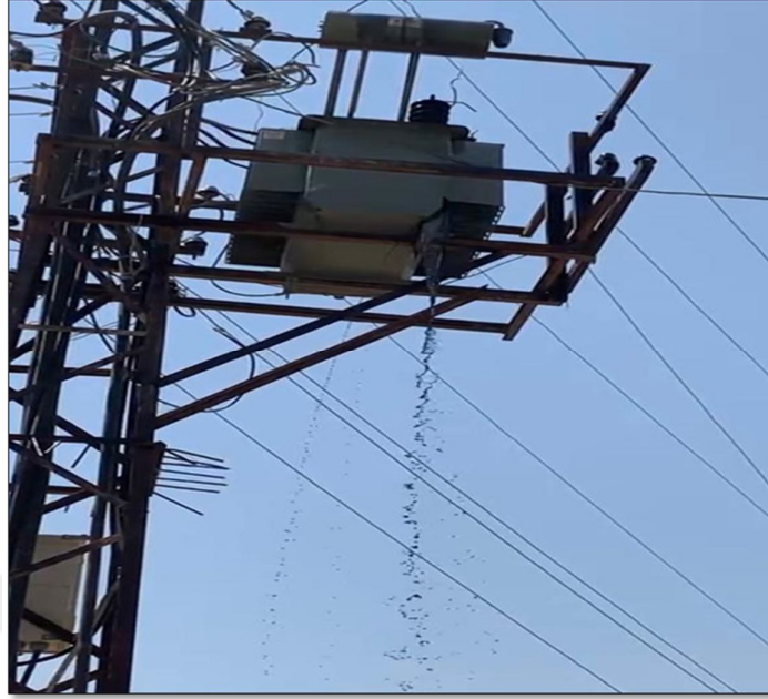
Şekil 3.1. Trafo Yanmasından Dolayı Yağ Deposunun Delinmesi
