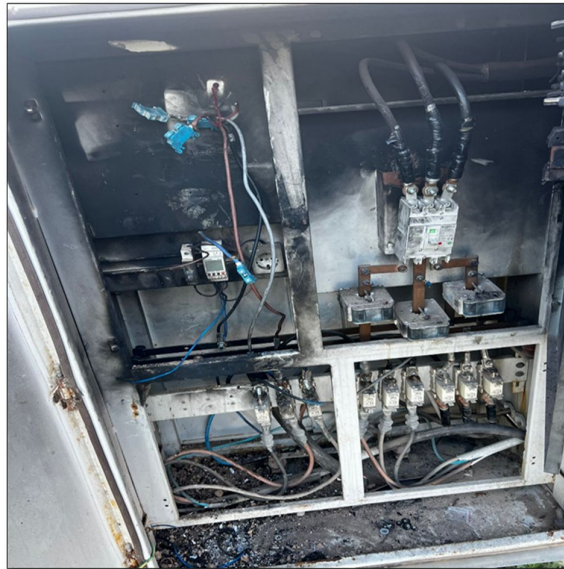
Şekil 3.10. dağıtım panosu aydınlatma kontaktör yanması
