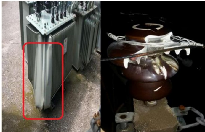
Şekil 3.12. Şarjlı havalarda yıldırım kaynaklı oluşan arızalar (Doğanay, 2022).
