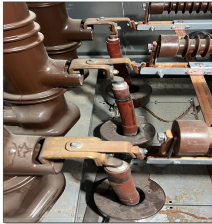
Şekil 3.3. XLPE kablo başlığı arızası
