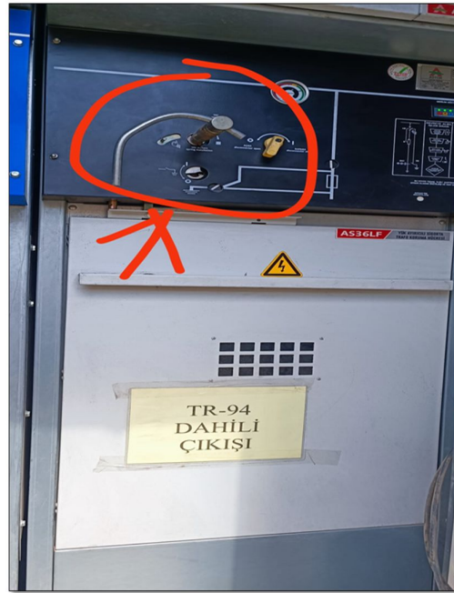
Şekil 3.5. Kurulumu Yapılmayan Kesici
