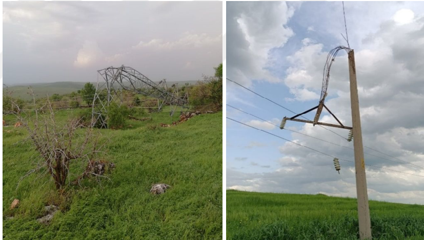
Şekil 3.11. Rüzgâr nedeniyle oluşan arızalar
