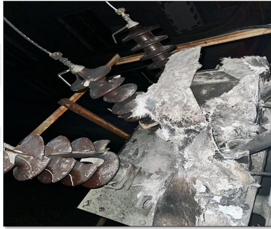
Şekil 3.9. Trafo Üstü OSOS Pano Bağlantı Hatalarından Dolayı Yanması Ve Trafonun Devre Dışı Kalması
