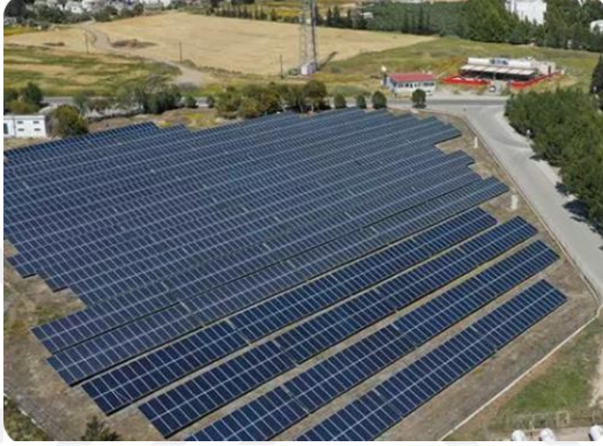
Şekil 3.5: Uluslararası Kıbrıs Üniversitesi Güneş Enerji Panelleri.
