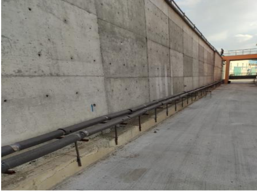
Şekil 4.11. Kompresör boruları görünümü
