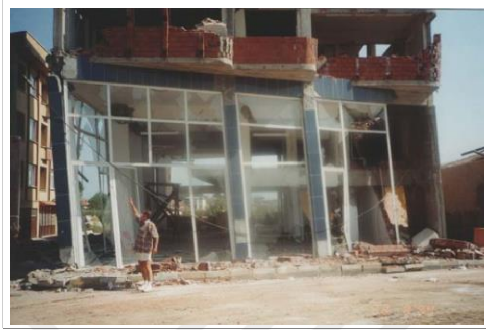
Şekil 2.6: Zayıf kat düzensizliğinden ötürü hasara uğramış bir bina.
