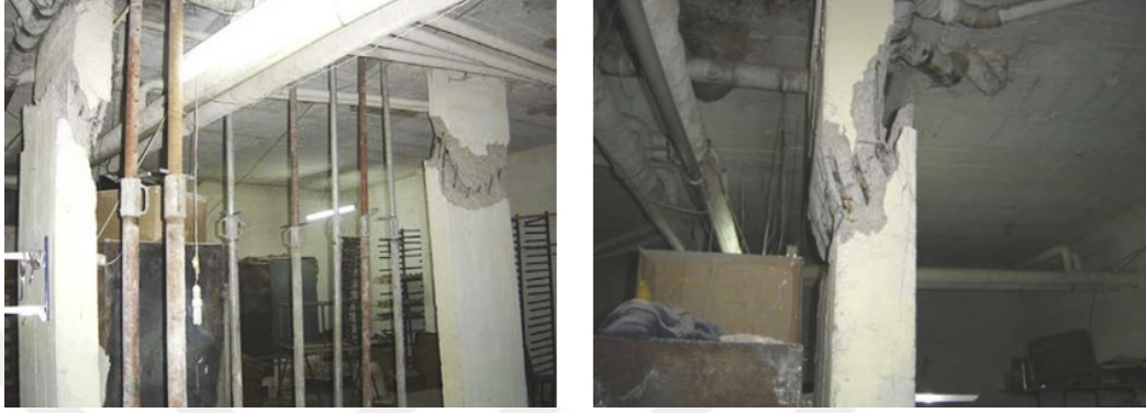
Şekil 1.6 : Yüksek eksenel yük oranından kaynaklı geniş betonarme kolonlarda gözlemlenen hasarlar (Kaltakci ve diğ, 2007).
