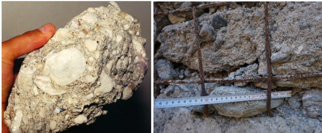
Şekil 1.3 : Düşük beton kalitesine örnekler: 1999 Kocaeli (Çağatay, 2005), 2020 Sivrice (Yurdakul ve diğ, 2021).
