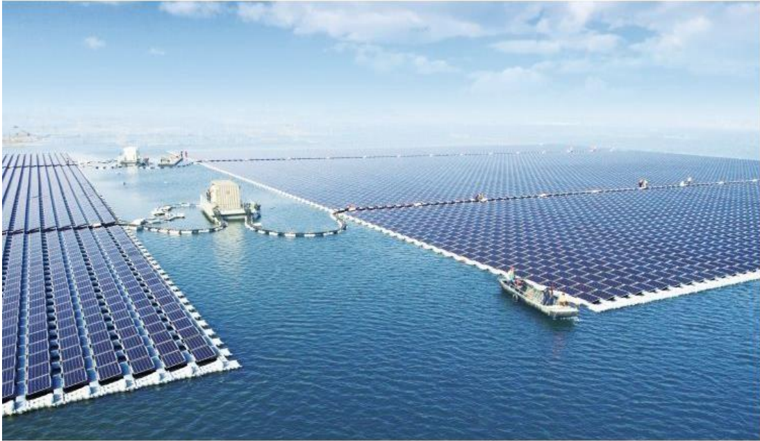
Şekil 2.16. Evirici ve elektriksel ekipmanlarının yüzdürüldüğü sistem örneği [21]
