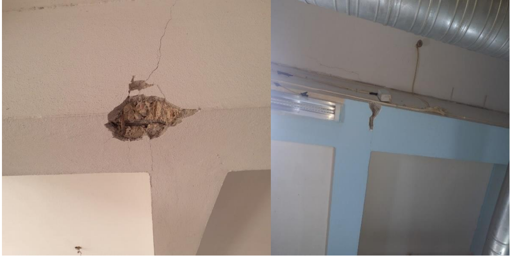
Şekil 1.1. Saplama kirişten dolayı esas kirişte oluşan çatlaklar (AFAD,2020)
