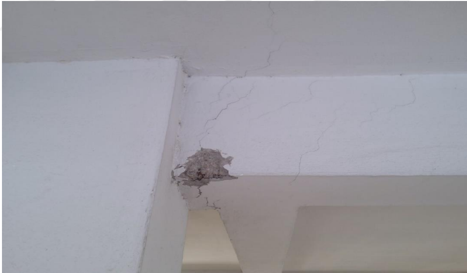
Şekil 1.2. Kolon dibine saplanan kirişten dolayı esas kirişte oluşan kesme çatlakları (AFAD,2020)
