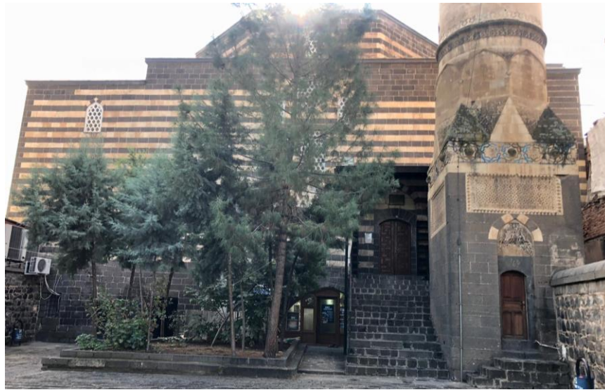
Şekil 1.6 Diyarbakır Melik Ahmet Paşa Cami’de oluşan renk solmaları
