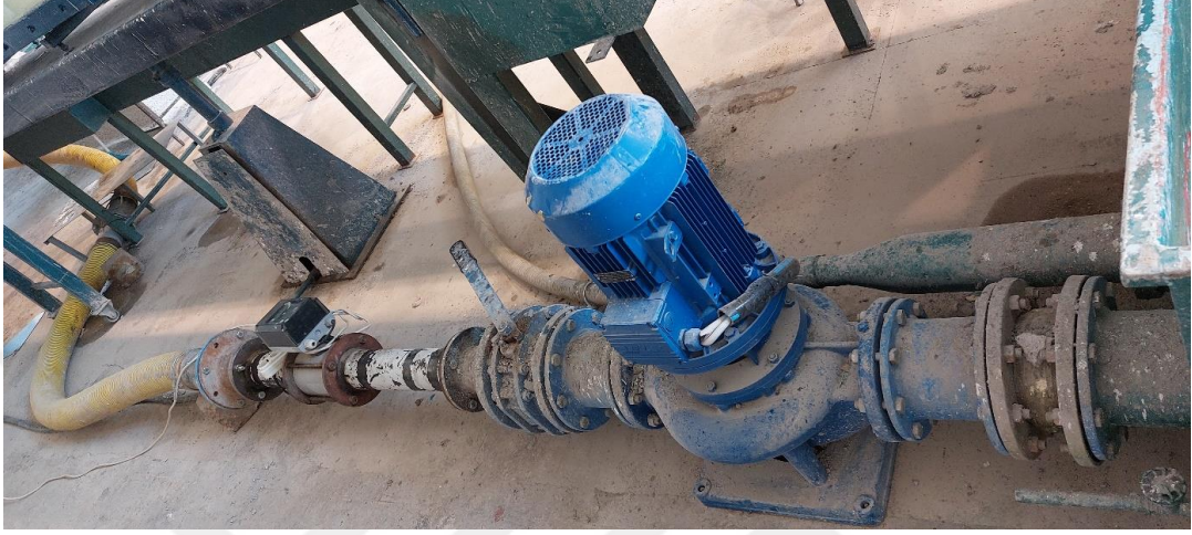
Şekil 4.3. Deneysel çalışmada kullanılan besleme hattı ve pompa
