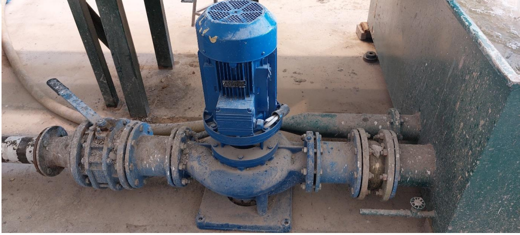
Şekil 4.13. Ana kanal debisinin ayarlandığı debimetrenin ön kısmındaki vana
