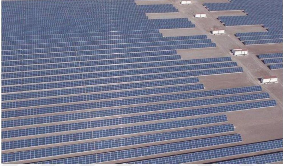
Şekil 27. Kayseri’de bulunan 50 MW kapasiteli OSB güneş enerjisi santrali (Url 32)
