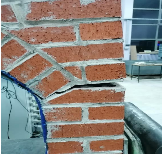
c) Üzengi taşı seviyesinde çatlama (sağ ayak)
