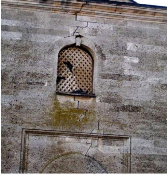
a) Yığma yapıda kilit taşında açılma
