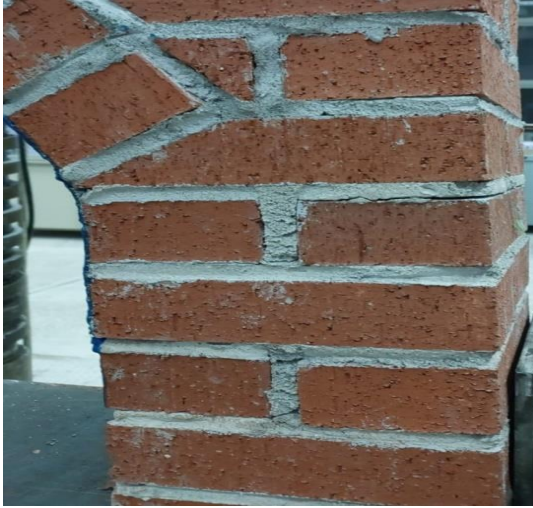
c) Üzengi taşı seviyesinde çatlama (sağ ayak)
