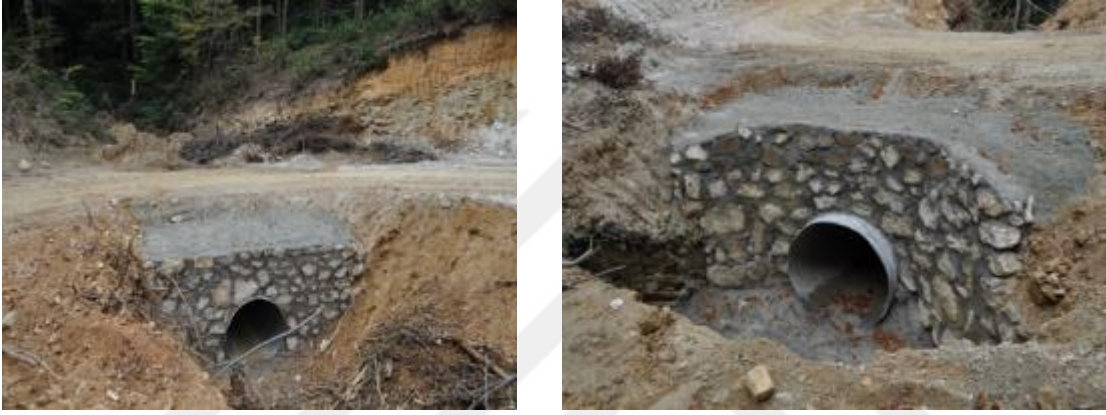
Şekil 4.10: Menfez baş duvarları
