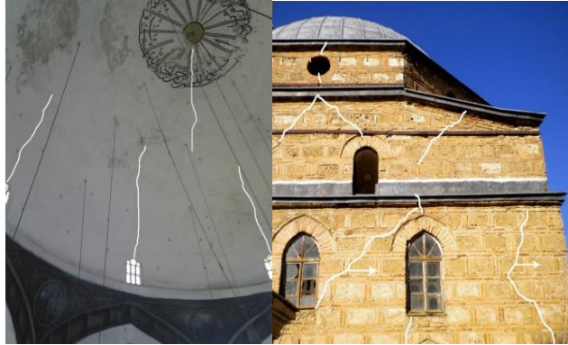
Şekil 6: Mirahor İlyas Bey Camide Tespit Edilen Kubbe ve Duvar Çatlakları, (Mustafaraj ve Yardım 2013)
