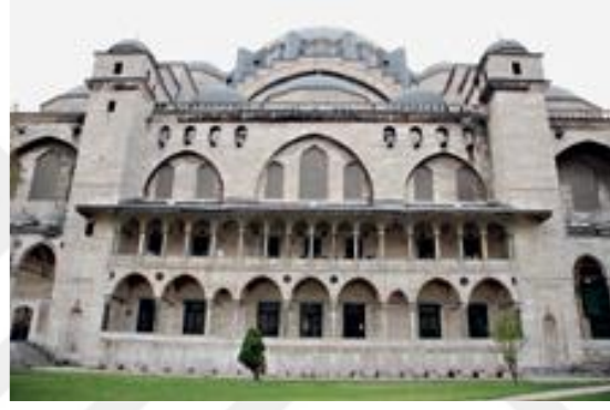
Şekil 34: Süleymaniye Cami Restorasyon Uygulamaları Öncesi Doğu Cephede Görülen Karbon Birikimi, (Ersen, Olgun ve ark. 2011)
