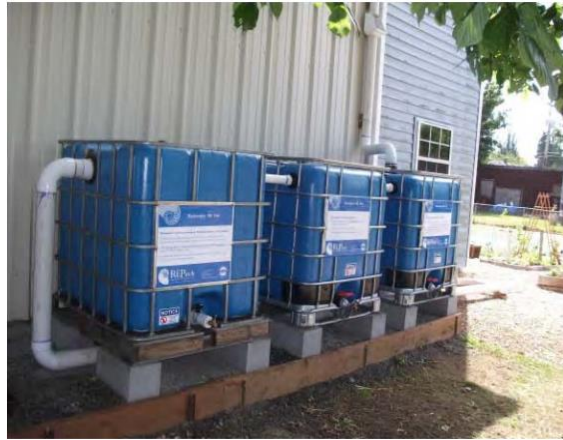
Şekil 5. Yer Üstü Yağmur Suyu Depolama Tankı [9]
