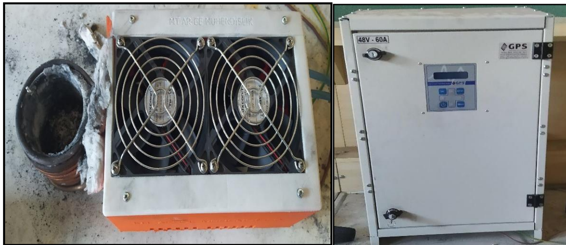
Şekil 3.1. İndüksiyon ocağı ve indüksiyon ocağı elektrik panosu
