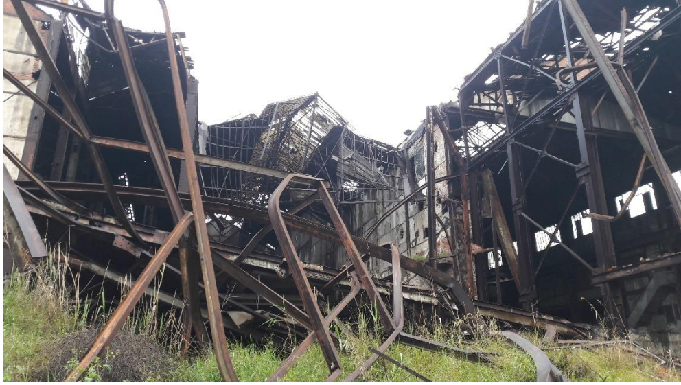
Şekil 4. 4. Elektrik Fabrikasının zarar gören çelik strüktürü ve çatısının görünümü
