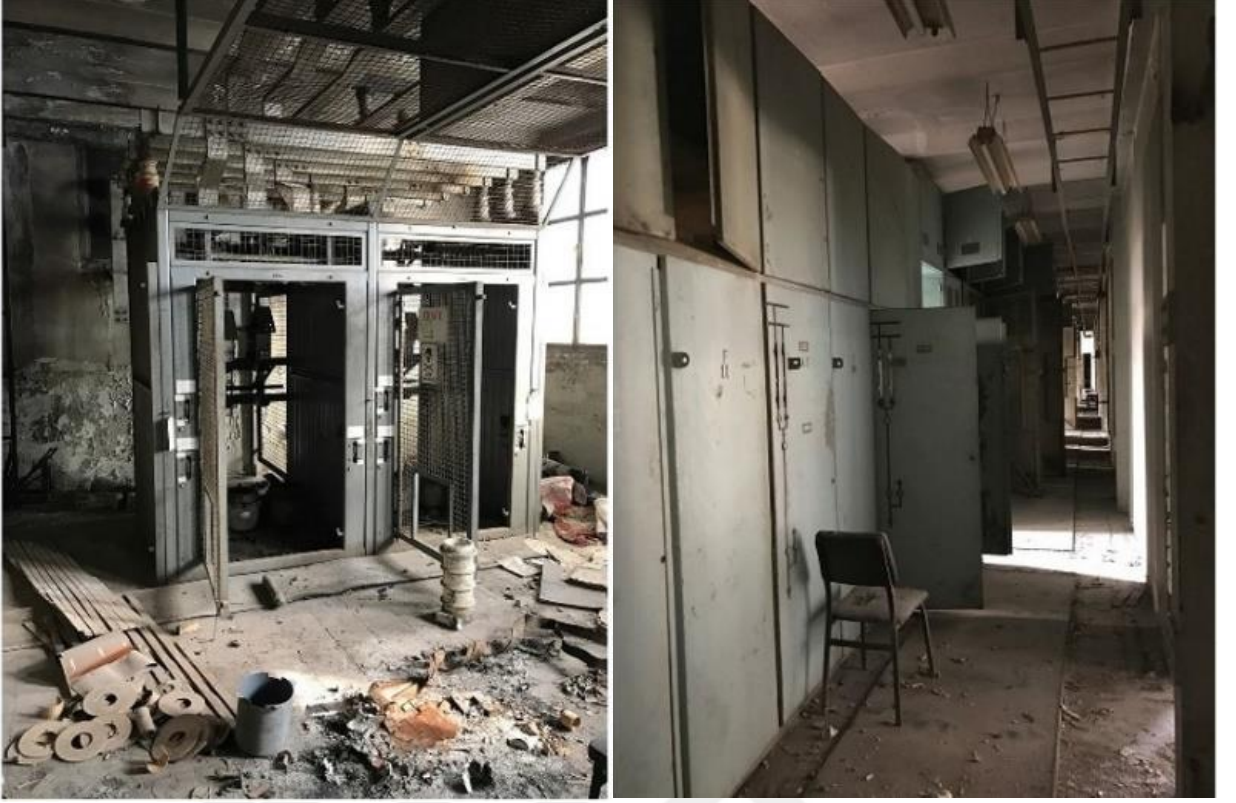
Şekil 4. 21. Şekil 4.20’de gösterilen 2 numaralı alan olan trafo bölümü ve 3 numaralı alan
