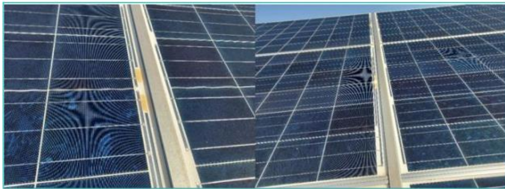
Şekil 3.31 Aşırı ısınmaya bağlı oluşan PV modül hasarları
