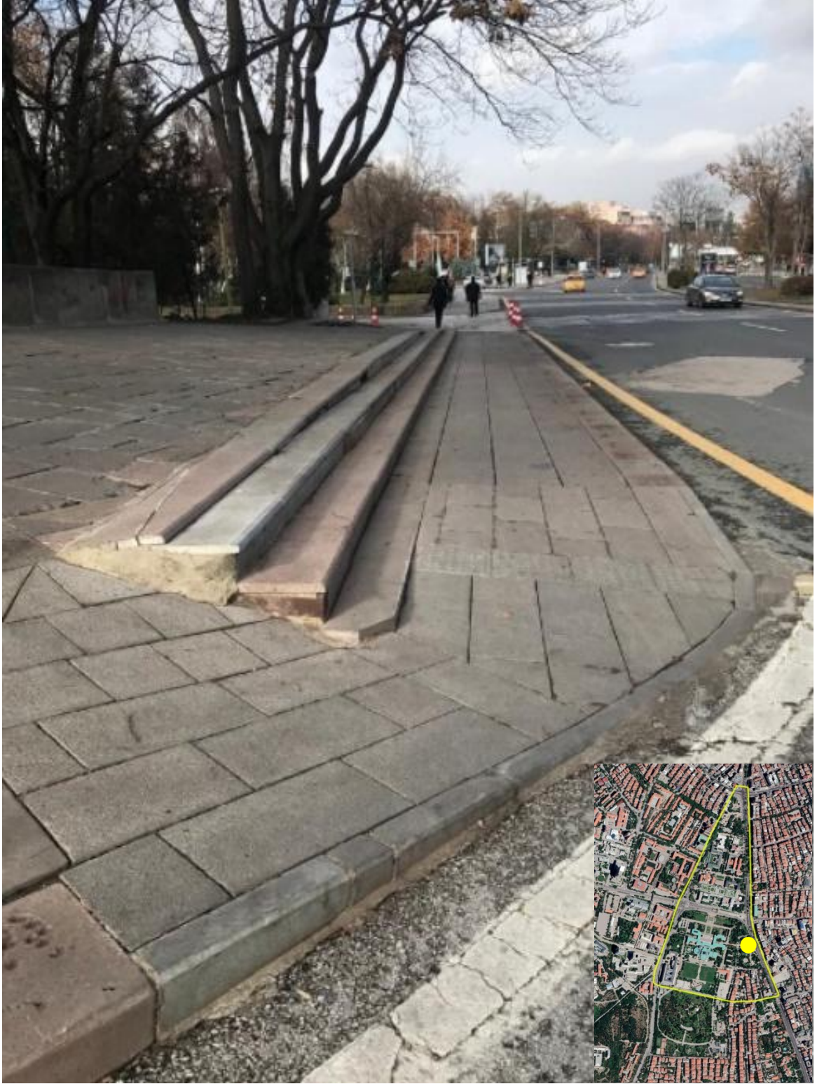
Görsel 54. ( kaynak: kişisel arşiv) Atatürk Bulvarında rampa, merdiven ve hissedilebilir yürüme yüzeyleri standartlara uygun görülmemektedir. Uygulamada eğimli bir alanda konumlandırılan merdiven basamakları ve kaldırım 3 cm kaldırım rampasında kot bulundurmaktadır. Kotlar nedeni ile geçişler engellilere sorun yaratmaktadır. Merdivenlerde ise tırabzan (korkuluk) olmalıdır. Görme engelliler için oluşan kot farkları ve uygun yürüme yüzeyi olmaması kullanımlarını zorlaştırmaktadır.
