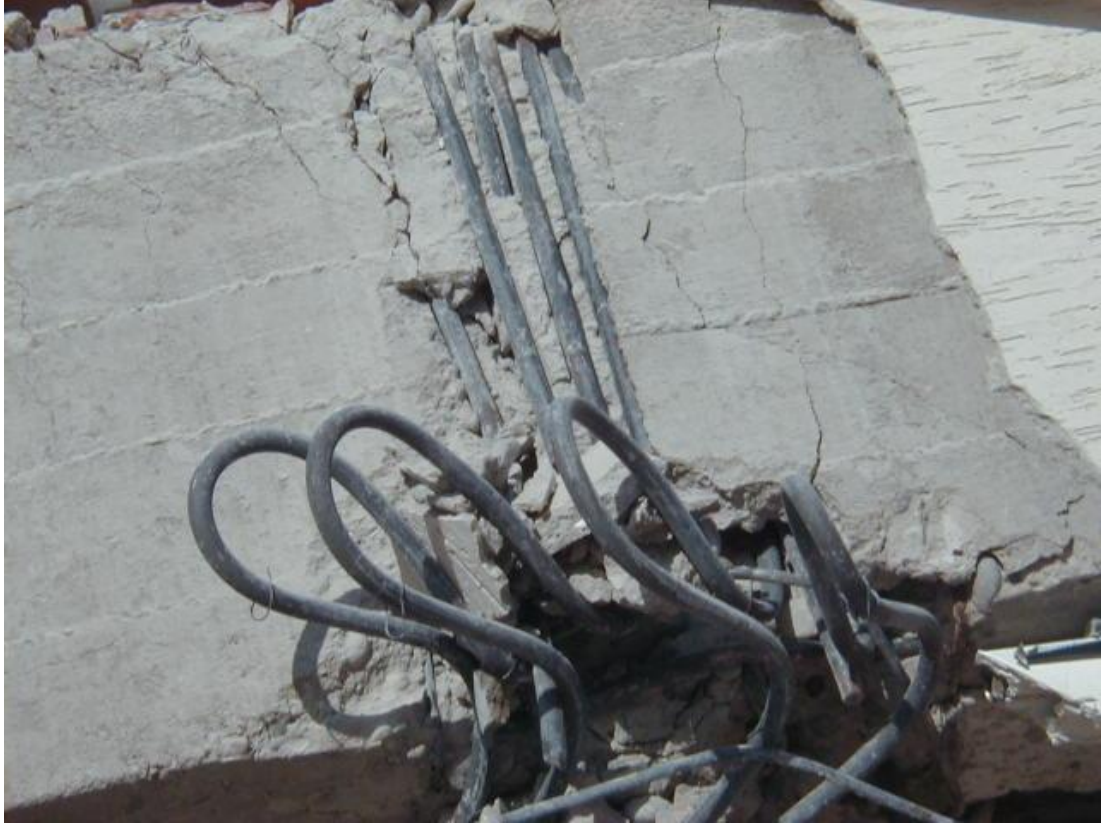
Şekil 5.11 Kolon Kiriş birleşim Bölgesinde İleri Hasar
