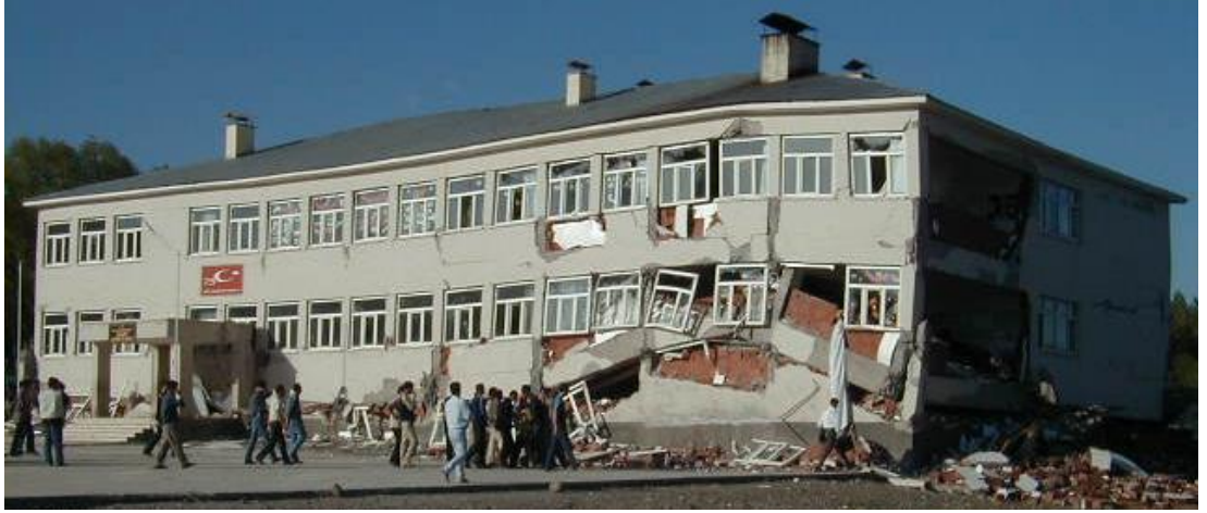
Şekil 5.4 Okul Binası Hasar Durumu
