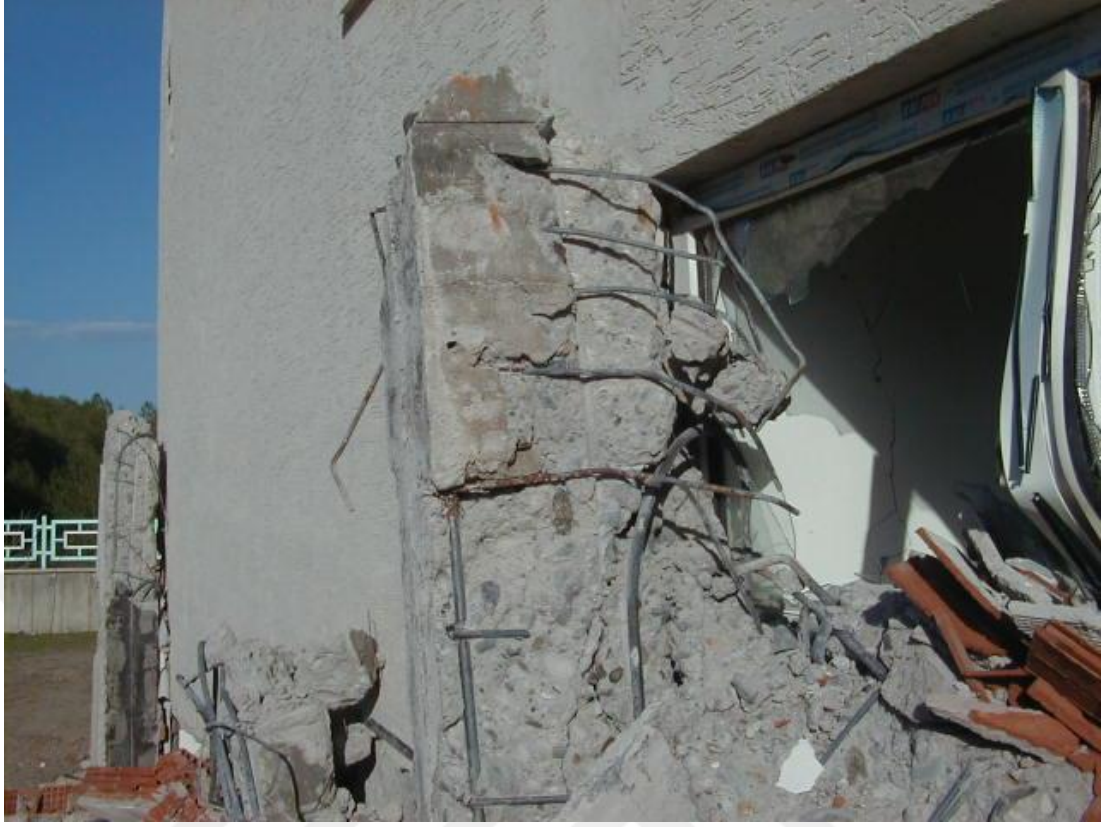
Şekil 5.8 Kolonun Birleşim Bölgesinde Sıyırılması
