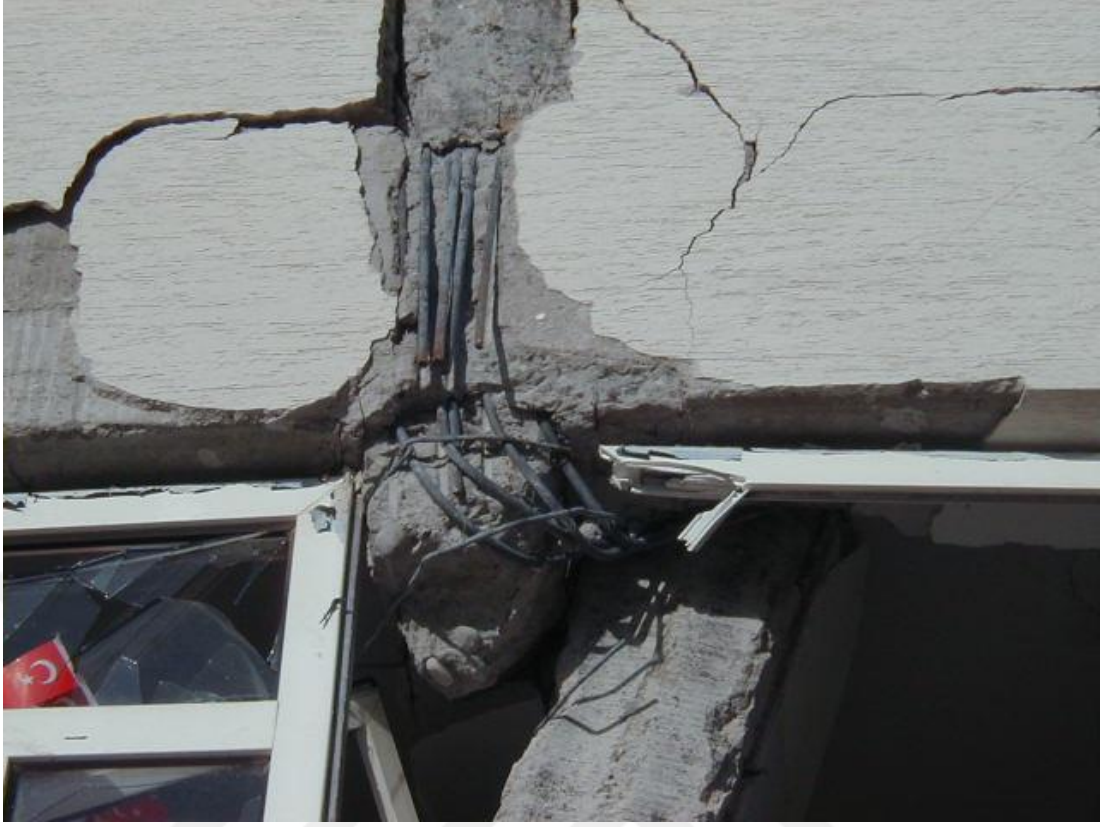
Şekil 5.6 Boyuna Donatının Hatalı Yerleşimi ve Kesme Hasarı
