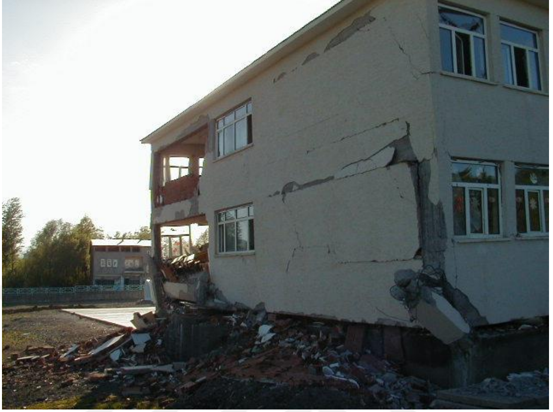
Şekil 5.12 Dolgu Duvarlarda Düzlem Dışı Hasar
