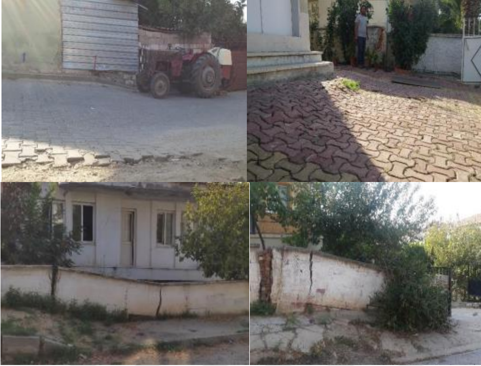
Şekil 3.5 Sarıgöl ilçe merkezinde, yüzey deformasyonları ve konut hasarları (Gül 2016).
