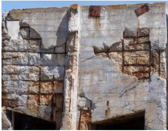
Şekil 1.1: Korozyona uğramış betonarme blok [1].
