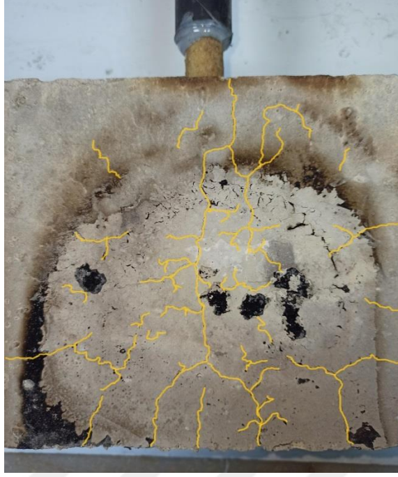
Şekil 4.9: Yüksek ısıya maruz numunelerin ön yüzeyindeki kılcal çatlaklıklar (<0,5mm).
