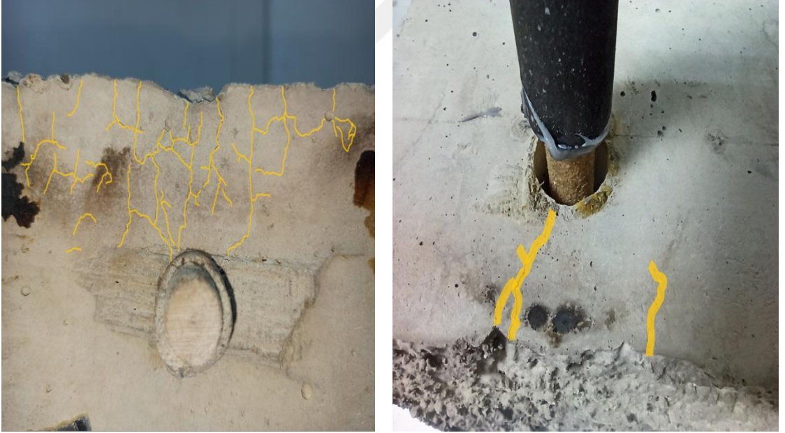
Şekil 4.10: Yüksek ısıya maruz numunelerin alt ve üst yüzeyindeki kılcal çatlaklıklar (<0,5mm).
