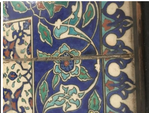
Resim 5.43. Kılcal çatlak ve çizikler
