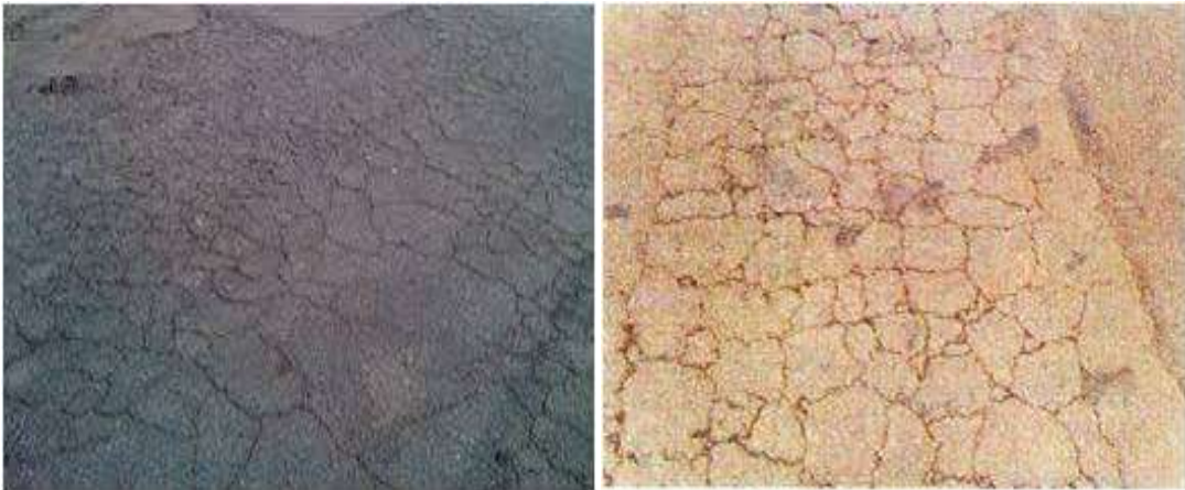
Şekil 2.3. Yol üzerindeki timsah sırtı çatlakları (A.K. Bakımı, 2018).
