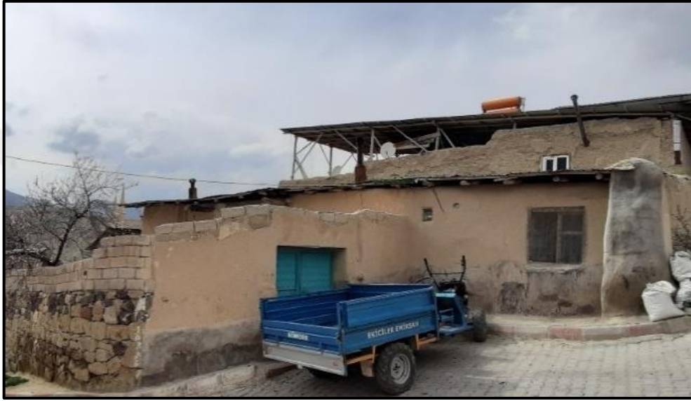
Şekil 4.33. Sac kaplama ile baca örneği
