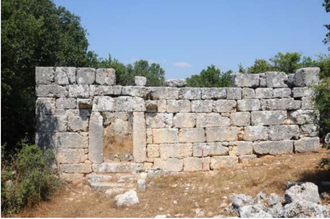
Şekil 4.1.3.9. Keşlitürkmenli Yolu Üzerinde Bulunan Çiftlik Evi, İkinci Kata Girişi Sağlayan Kapı Girişi
