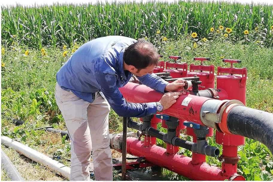
Şekil 4.8. Damla sulama sisteminde bulunan filtre sistemi
