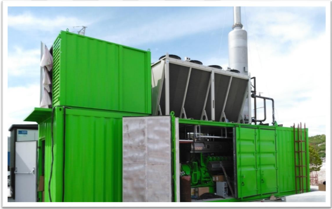
Şekil 4.3. Kütahya depolama sahası kojeneratif enerji santrali
