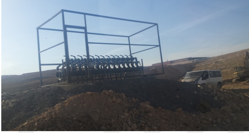
Şekil 4.11. Gaz Toplama İstasyonları (Şanlıurfa Büyükşehir Belediyesi, 2017)
