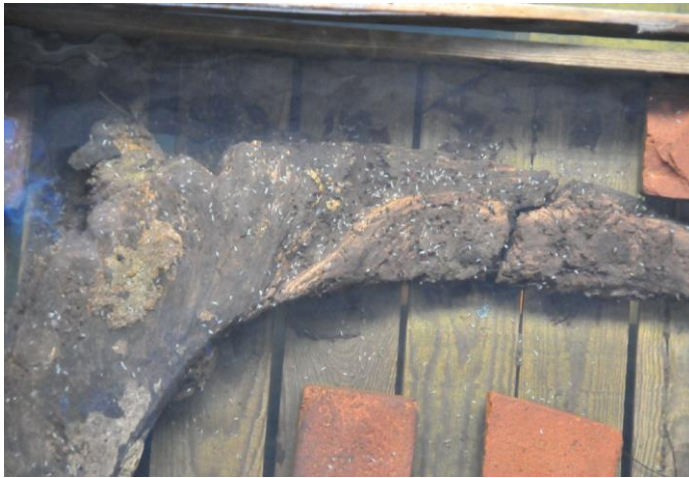
Fotoğraf 14: Exocite 1012 kullanımı sonrasında ahşap üzerinde beyaz noktalar halinde görülen ölmüş Limnoria lar. (Yenikapı Batıkları Projesi arşivi)
