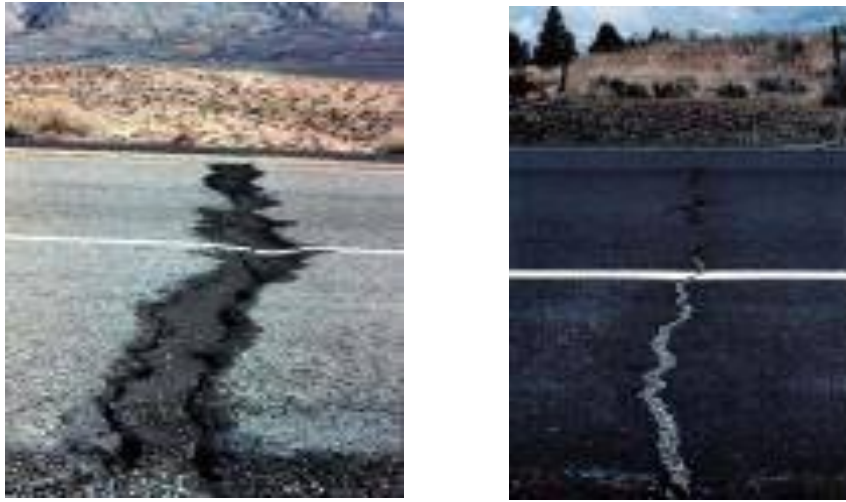
Resim 3.2. Esnek üstyapılarda düşük sıcaklık sebebiyle oluşan çatlamlar
