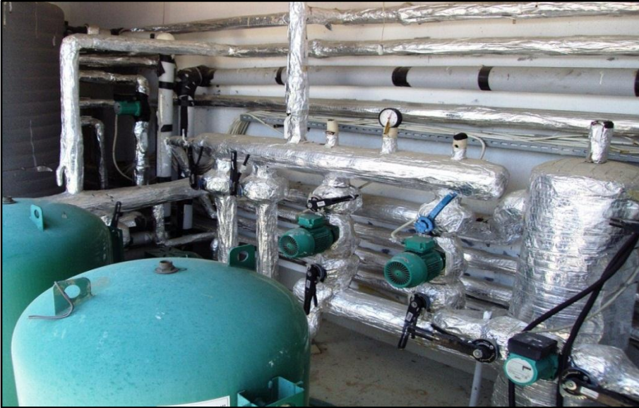
Şekil 4.7 Oteldeki soğutma hatları ve elemanları
