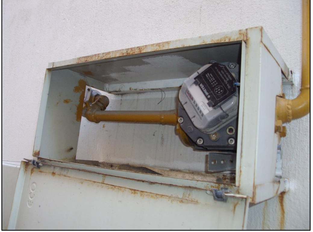
Şekil 6.4 Otel doğalgaz sayacı
