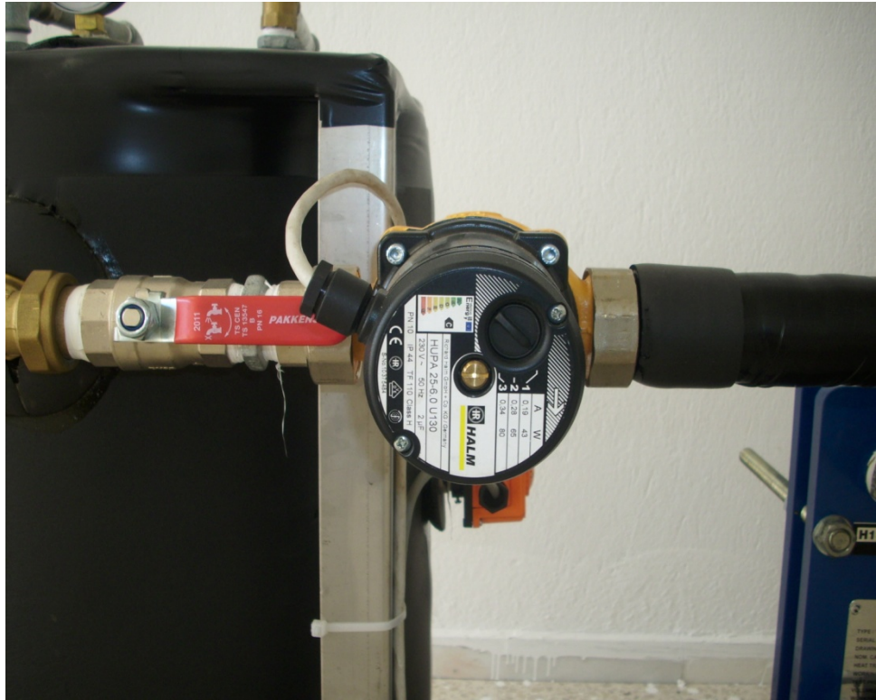
Şekil A.12. Akışkan devir-daim pompası (primer devre)
