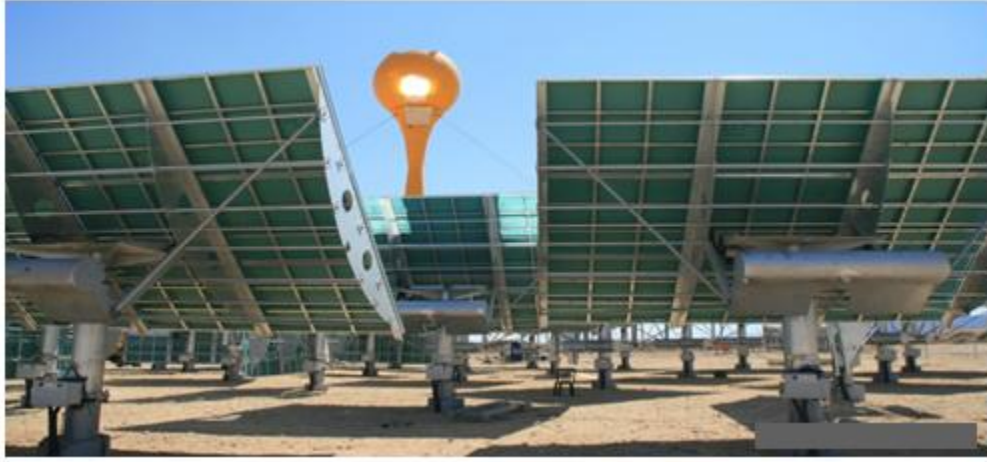
Şekil 3.6. Güneş lalesi ile elektrik üretimi-odaklayıcı aynalar
