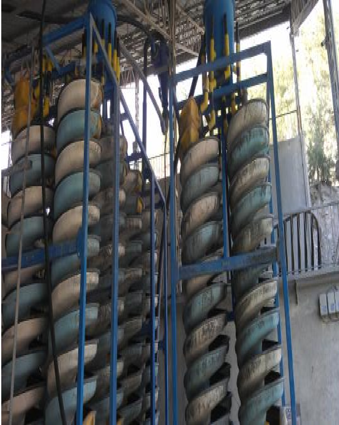
Şekil 3.5. Zenginleştirme Tesisindeki Siklon ve Spiraller
