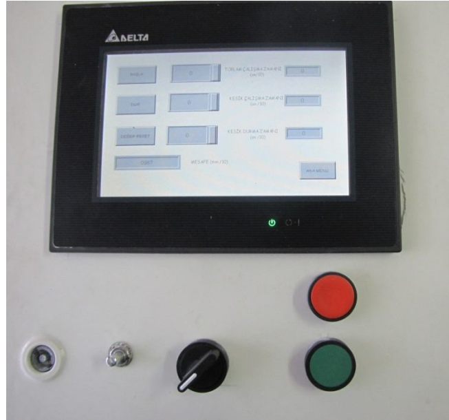
Şekil 4.7. Plc kontrol panosu
