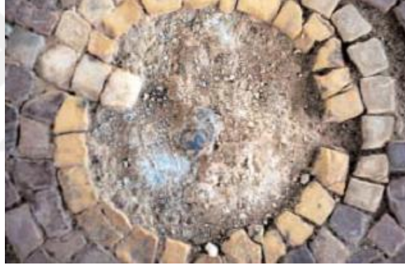
Resim 5.14. Taşıyıcı harç katlarında bozulmayı gösteren görsel
