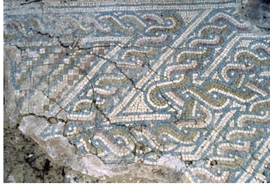
Resim 5.5. Mozaikli yüzeyde kırılma ve çatlama gösteren görsel
