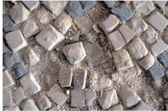
Resim 5.15. Taşıyıcı harç katlarında bozulmayı gösteren görsel
