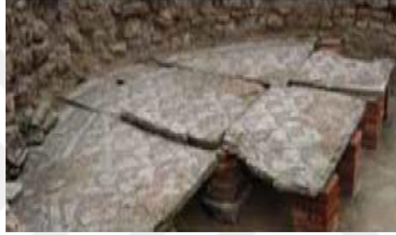
Resim 5.45 Taşıyıcıda yenileme uygulamasında hatayı gösteren görsel
