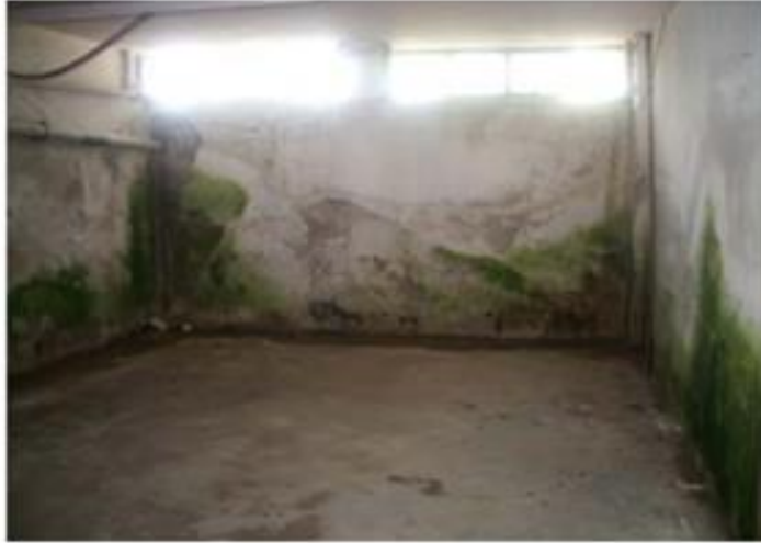
Şekil 2.14: Yeraltı suyunun etkisiyle betonarme yapıda meydana gelen hasar (Şimşek ve Akıncıtürk, 2006)
