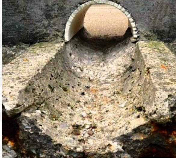
Şekil 2.6: Betonda erozyon örneği (Erosion Resistance of Concrete, 2024)
