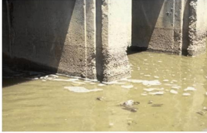
Şekil 2.10: Sülfat etkisiyle oluşan bozulma örneği (Çimsa, 2024)
