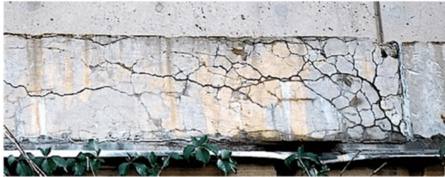
Şekil 2.9: Sülfat etkisiyle betonda oluşan bozulma örneği (Çimsa, 2024)
