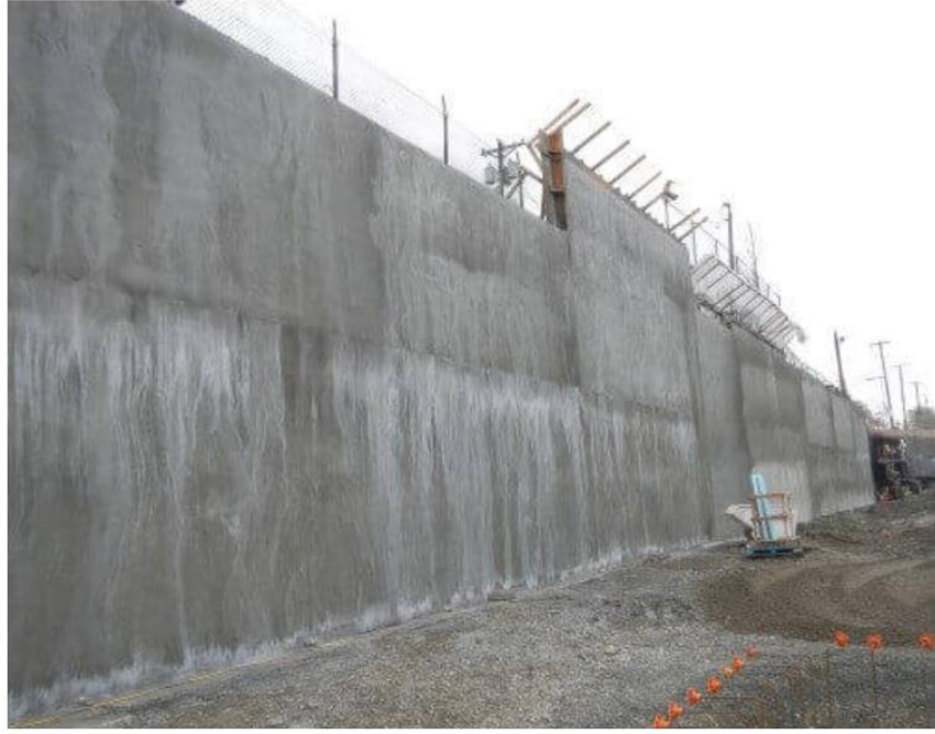
Şekil 2.11: Perde duvarında oluşan çiçeklenme (Engin, 2015)
