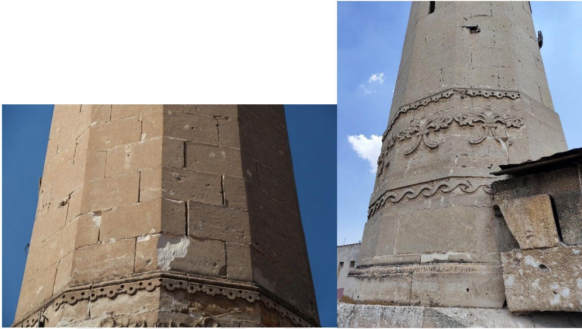
Resim 3.16. Minare gövdesinde derz açılmaları
