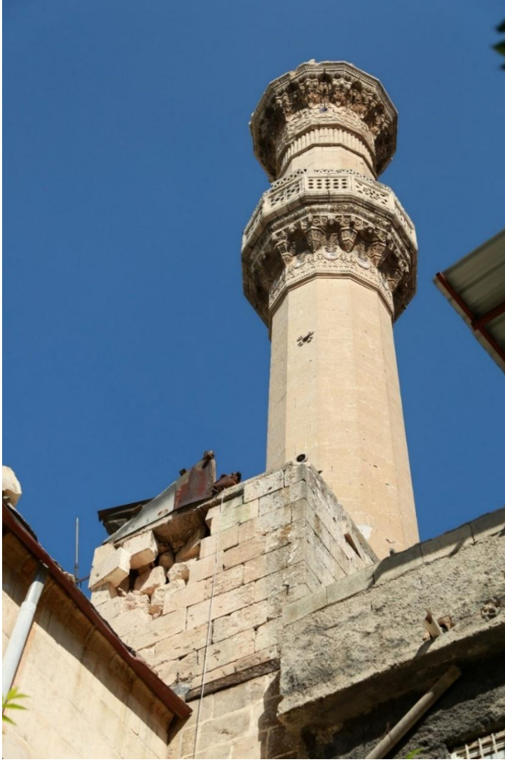
Resim 3.13. Minarenin kalan kısmı ve hasar gören alt kısım
