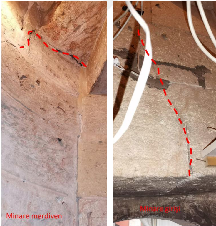
Resim 3.12. Minare merdiven ve kaidesindeki çatlaklar
