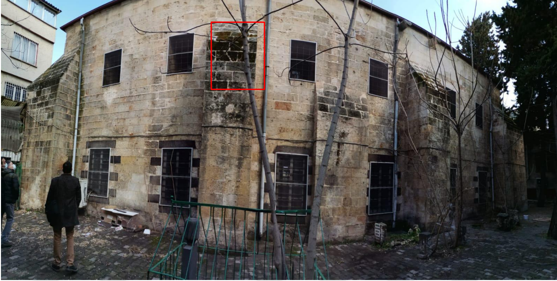
Resim 3.11. Güney cephede yosun oluşumu
