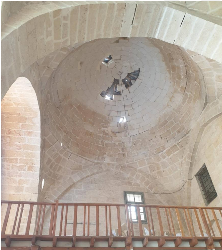
Resim 3.17. Kopan minare parçalarının cami kubbesine hasarı
