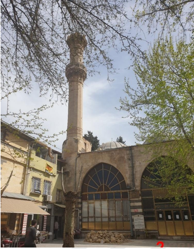
Resim 3.14. Minarenin depremden sonraki durumu
